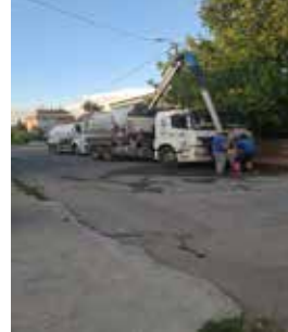
SEYDİŞEHİR SAADETLER MH. KANAL ŞEBEKE ARIZASININ GİDERİLMESİ
