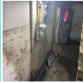
Meram Yenişehir Mahallesi kanal ana şebeke arızasından kaynaklı hasar
