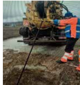
HÜYÜK GÖRÜNMEZ MH. KANAL TIKANIKLIĞI ARIZASININ GİDERİLMESİ
