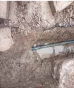
EREĞLİ DOĞUALAGÖZLÜ MH. SU ŞEBEKE HATTI ARIZASI
