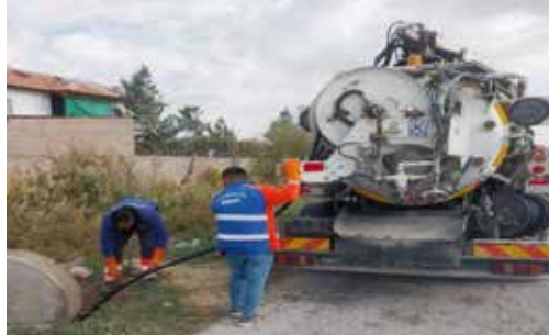
EREĞLİ ALHAN MH. KANAL ŞEBEKE ARIZASININ GİDERİLMESİ
