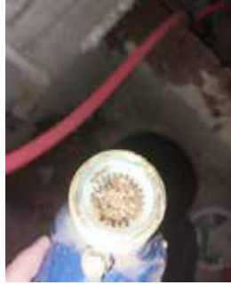
BOZKIR BAĞYURDU MH. SU AKMIYOR ARIZASININ GİDERİLMESİ
