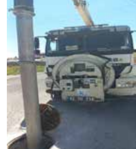
SEYDİŞEHİR SAADETLER MH. KANAL ŞEBEKE ARIZASININ GİDERİLMESİ
