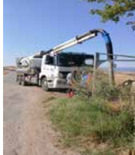
AKÖREN AĞALAR MH. KANAL ABONE ŞUBE YOLU ARIZASININ GİDERİLMESİ
