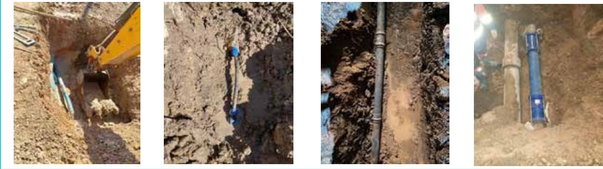
BOZKIR DEMİRASAĞ MH. SU ŞEBEKE HATTI ARIZASI
